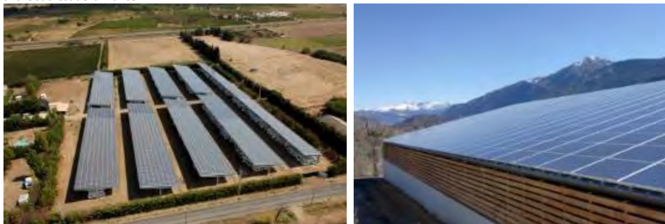
Figure 9 : Exemples d'installations photovoltaïques exploitées par JPee : les ombrières du Bosc (à g.) et la centrale d'Embrun (à d.)
